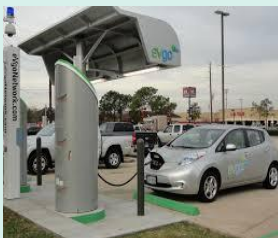
Bornes de recharges pour véhicules électriques
