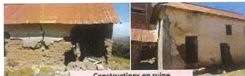
Constructions en ruine
